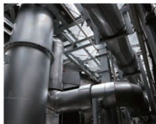
プラント配管
