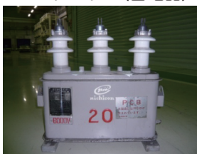
コンデンサー(蓄電器)
