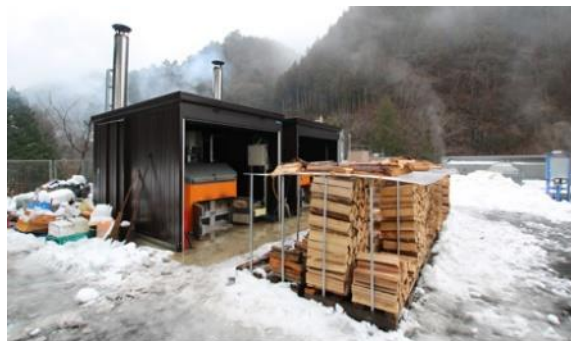
檜原温泉センターの薪ボイラー 55
