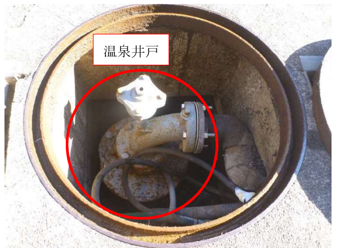
③ 温泉井戸周辺状況
