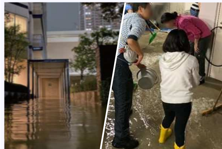
写真 タワーマンションの浸水被害 (パークヒルズ武蔵小杉SFT管理組合提供)
