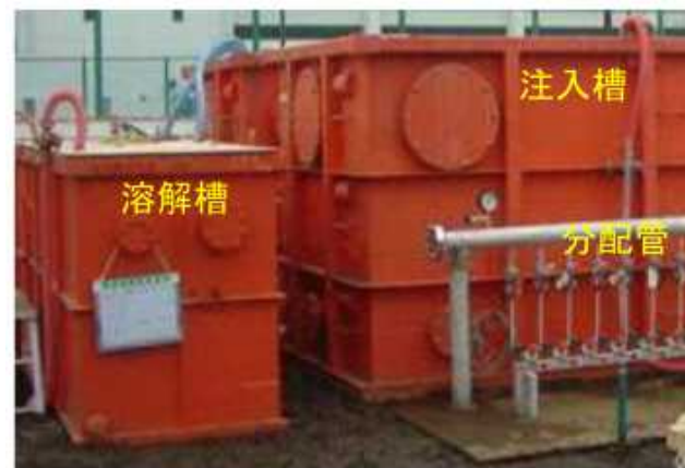
クロロクリン注入設備例
