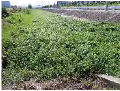
水路のコンクリートブロックで繁茂(*1)
