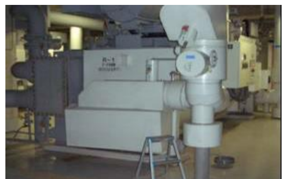
ターボ冷凍機
