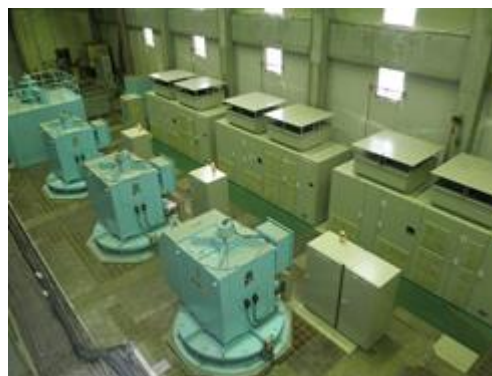
電動機、インバータ制御装置
