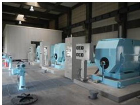
図1. ポンプ用電動機
