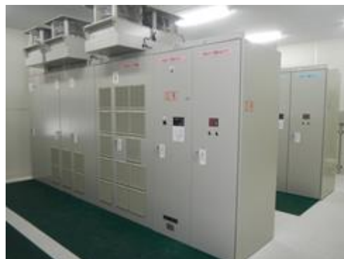
図2. インバータ制御設備
