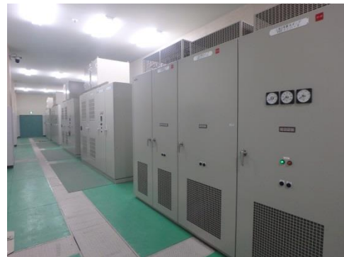
送配水ポンプ用インバータ装置
