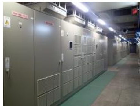
図1. 送配水ポンプ用インバータ装置
