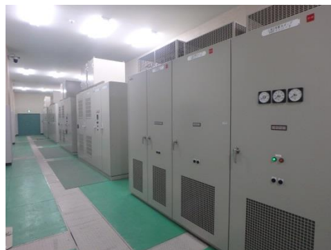
送配水ポンプ用インバータ装置
