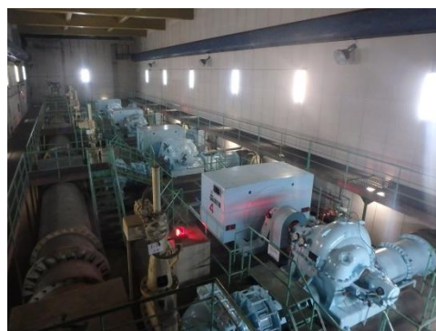
高効率上水道ポンプ
