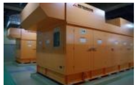
【コージェネレーションシステム】
