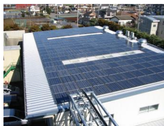
太陽光発電システム
