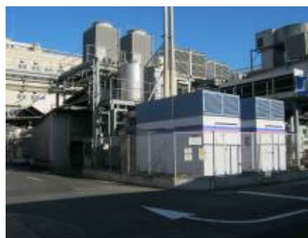
ガスエンジンコージェネレーション設備
