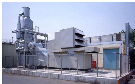
ガスタービンコージェネレーション設備
