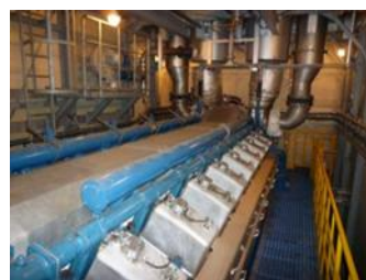
ガスエンジンCGS
