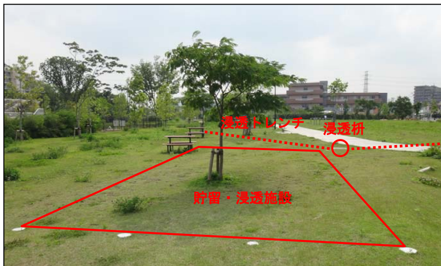
写真 7.2-1 雨水貯留浸透施設設置状況 (地下) (1号公園)
