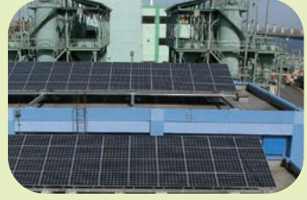
太陽光発電設備
